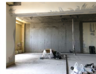
マンションフルリノベーションは、構造躯体のみを残して、内装・内壁をすべて撤去します。
